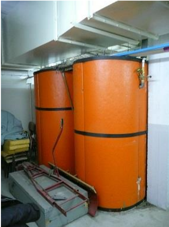
Warmwasserspeicher je 1000 Liter
